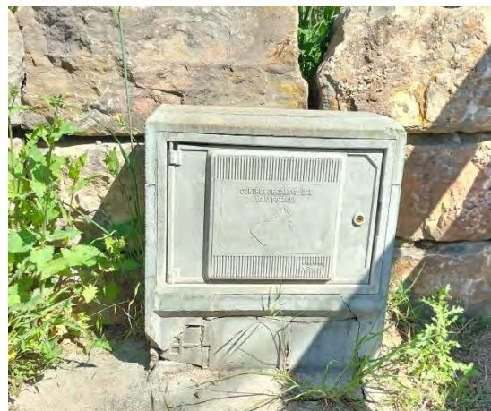
Figura 44. Arqueta presa de mostres.
