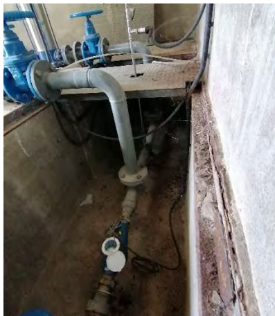
Figura 24. Comptador sector Can Barrina.
