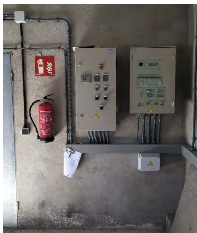
Figura 26. Quadres elèctrics Can Barrina.
