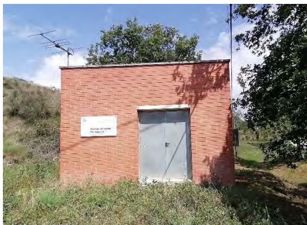
Figura 22. Bombament elevació Can Barrina.
